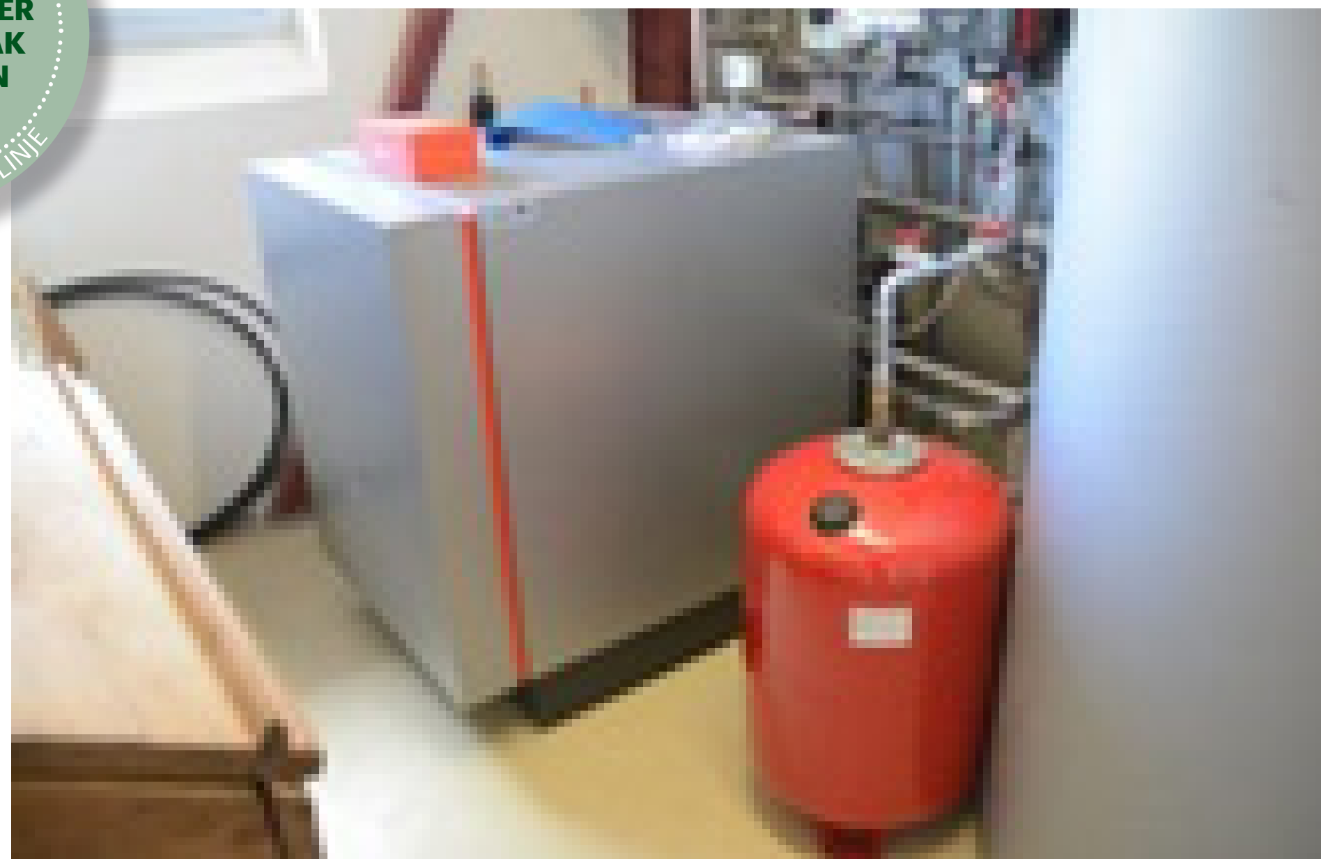
Et gyllekølingsanlæg består af PEL-slanger i gulvet under gyllen samt en varmepumpe, der trækker varmen ud af vandet, der cirkulerer i PEL-slangerne Foto: Byggeri & Teknik
