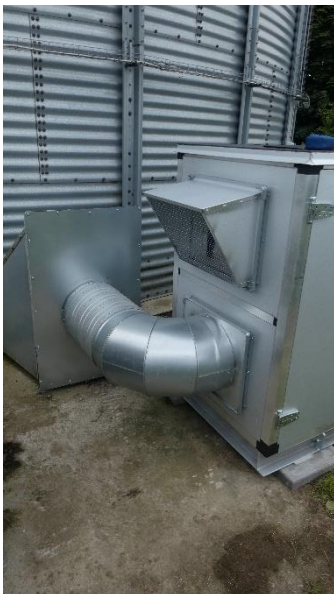
Billede 3. Enheden koblet på silo.
