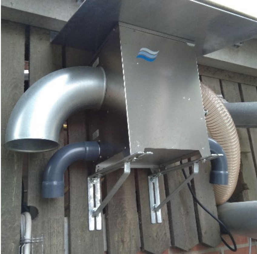
Foto 3: Lufttørrer fra SKIOLD placeret med rør til U-rende ved vådfodertank.
