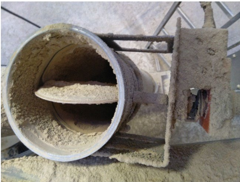
Foto 2: Spjæld påsat rør ved dysefilter og U-rende ved vådfodertank.
