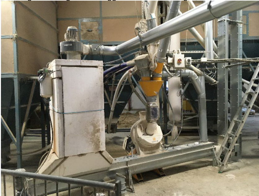
Foto 1: Mølle med snegelerende under og dysefilter helt til venstre. Dysefilteret var isoleret med flamingo.
