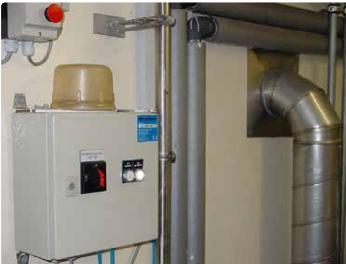
Foto 5. Styreskab til automatisk omskift mellem hovedtank og buffertank.
