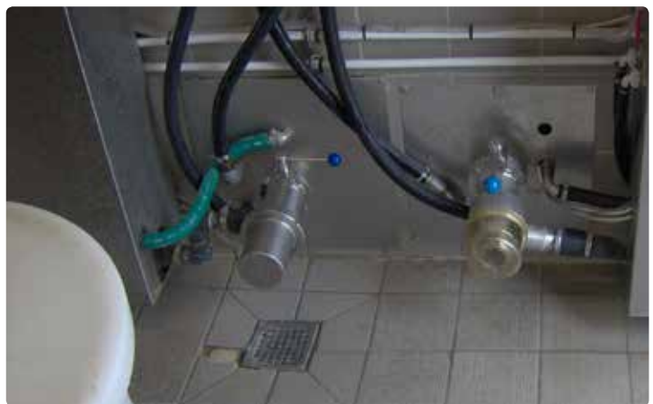
Foto 4. Tankstuds fra buffertank og hovedtank placeret ved siden af hinanden, så chaufføren nemt kan flytte slangen fra mælkepumpen.
