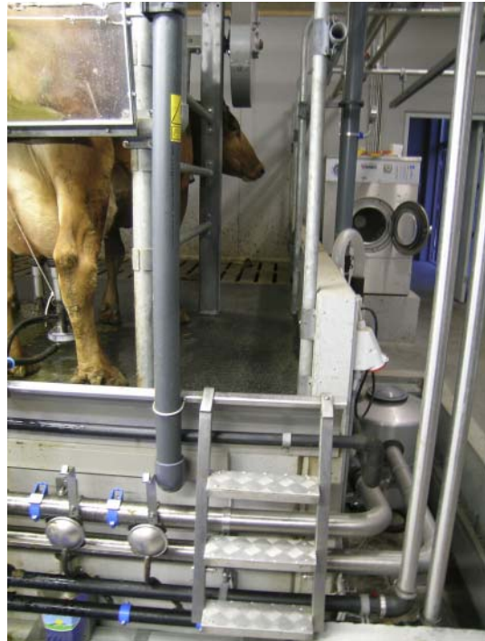
Figur 5.13. Trappe fra malkegang til malkepladserne. Det er besværligt for malkeren at komme forbi drivaggregat til frontbom/rotorbom.
