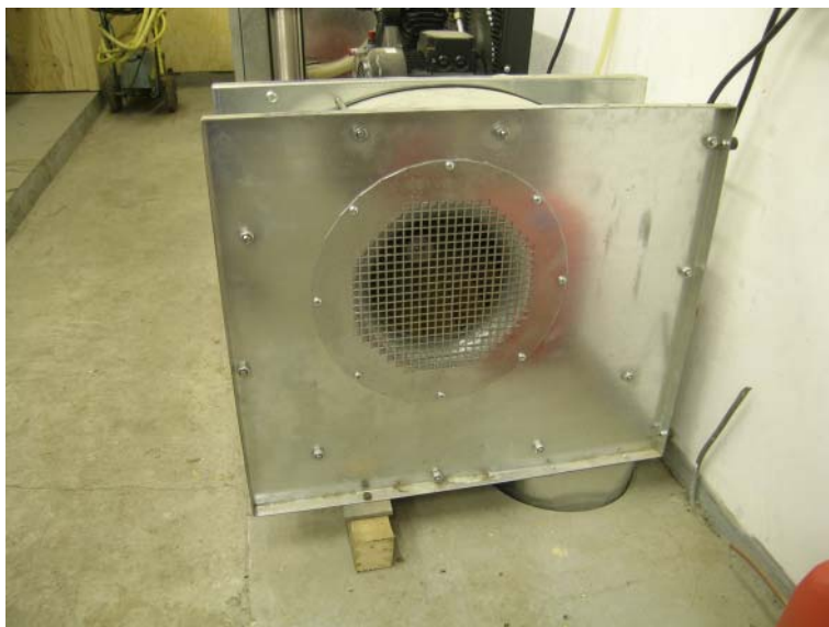
Figur 5.22. Ventilator til indblæsning af varm luft fra teknikrum/vakuumpumpe til malkestald kan give en del støj.
