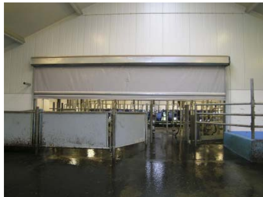
Figur 5.4. Rullegardin, der kan lukkes mellem opsamlingsplads og malkestald mellem malkninger. Malkestalden kan lettere holdes frostfri.
