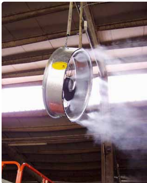
Billede 7. Højtryksskøling med blæser fra Tecno Cooling.
