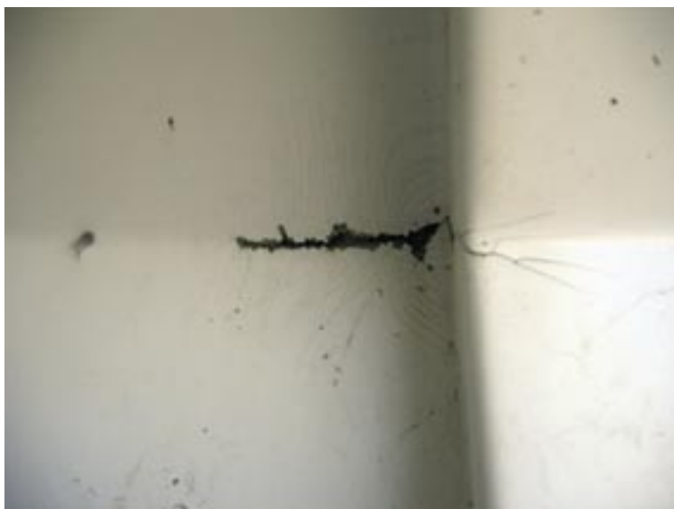
Figur 8 - Skade efter højtryksrensning.
