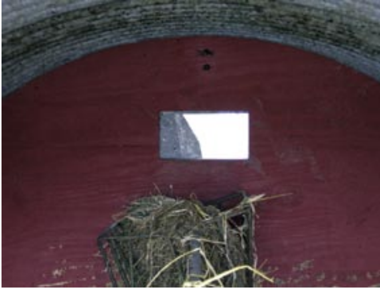
Figur 1 - Ventilationshul med skydeluge i "Kalvehytte (Spøttrup Hytten)".
