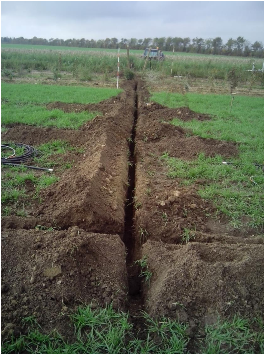
Figur 4. Rrender til nedlægning af slanger til sugeceller, som installeredes ved Låsby i september 2014 i triticales (forrest) og elefantgræs (bagerst).
