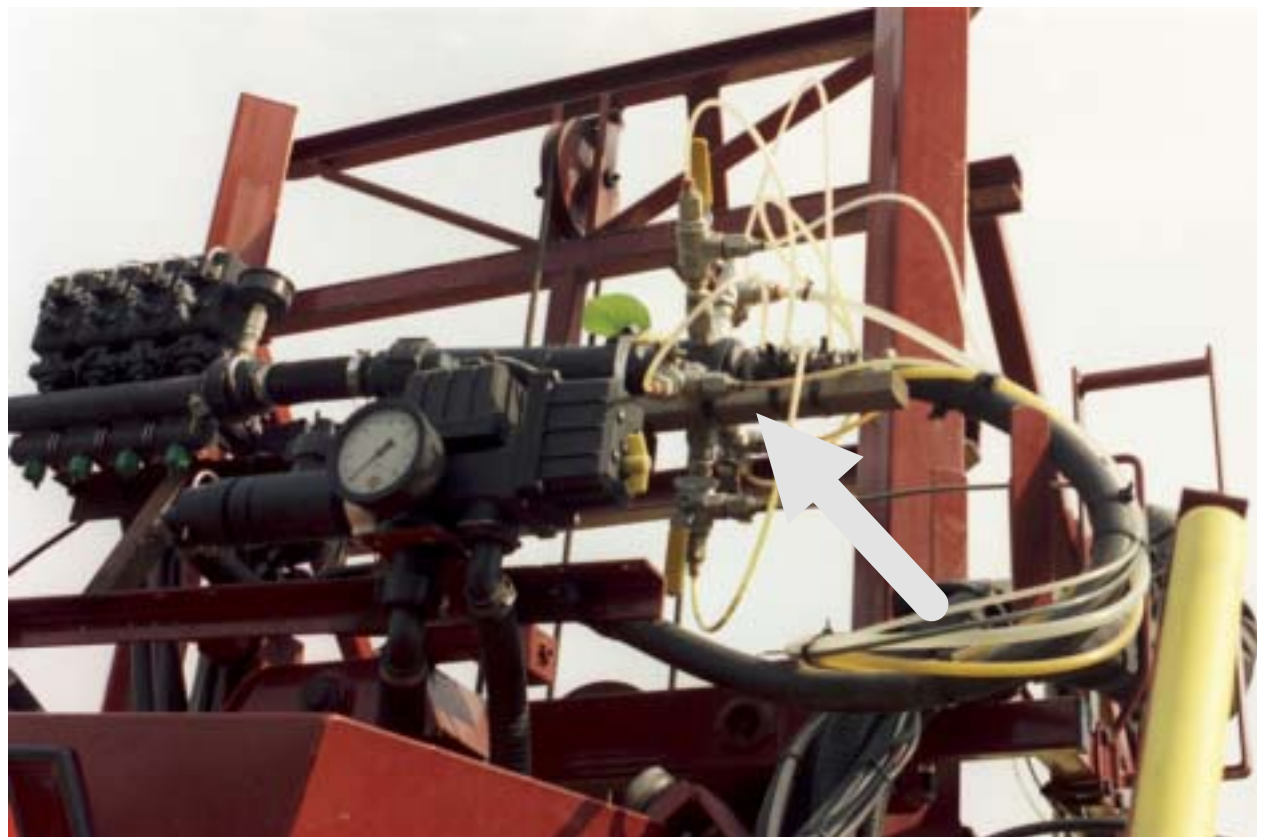
Injektionspunktet er placeret lige før armaturet.
