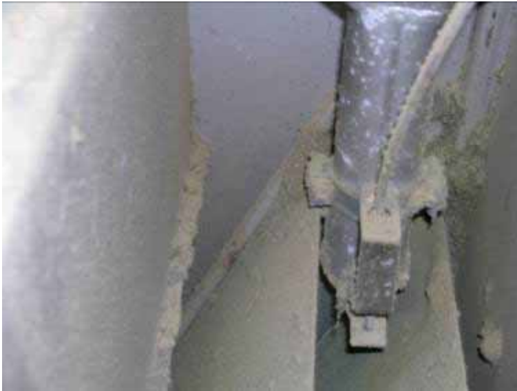
Figur 5.5. Udfodringsteknikken er gemt godt væk, og der kommer ikke meget snavs og foderrester. Til gengæld er adgangen dårlig, hvis der skal serviceres.
