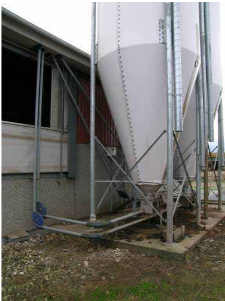
Figur 13.5. Siloanlægget var velkonstrueret og i velvalgte materialer. Her var ingen tegn på rust efter halvandet års brug.
