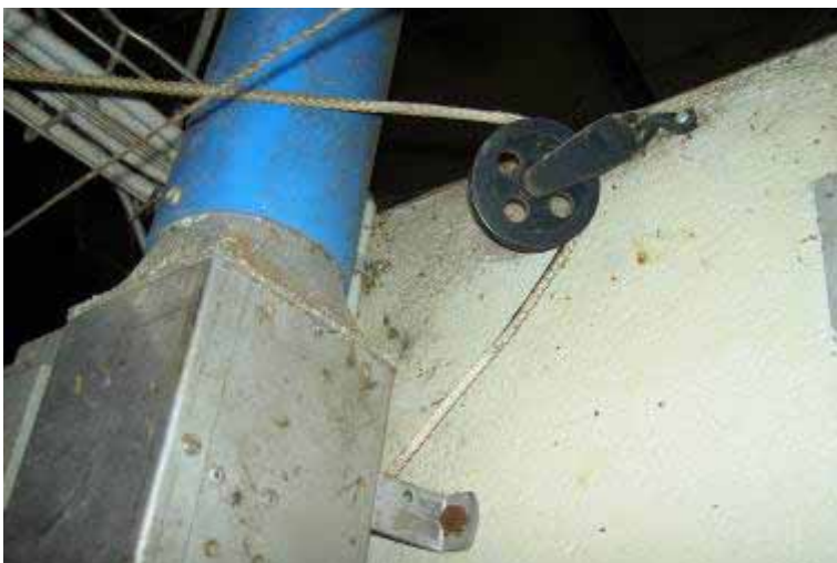
Figur 14.4. Forbindelsen fra udløserhåndtagene til automaterne sker via snore og trisser. Et simpelt men effektivt princip uden overflødige komponenter. Bolte og møtrikker burde være rustfri. Enkelte køer kan udløse foder ved at løfte hovedet og trække i snoren.
