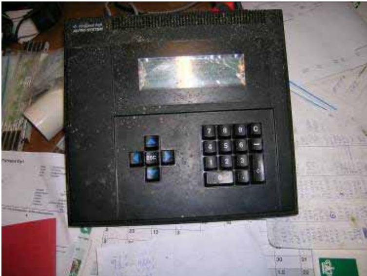
Figur 8.5. Programmering og styring foregår via en terminal. Brugervenligheden er tilfredsstillende og brugeren kan selv foretage alle ændringer og kalibreringer. Statistik og gode oversigter over foderforbruget kræver derimod en PC-løsning.
