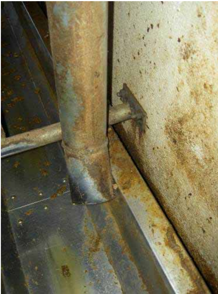
Figur 14.3. Udfodringen sker via et stålrør. Udformning og placering var tilfredsstillende, men der er tendenser til at det stopper til. Truget kunne være bedre udformet. Bemærk foderrester på kanten og specielt bag foderrøret er hygiejnen dårlig.
