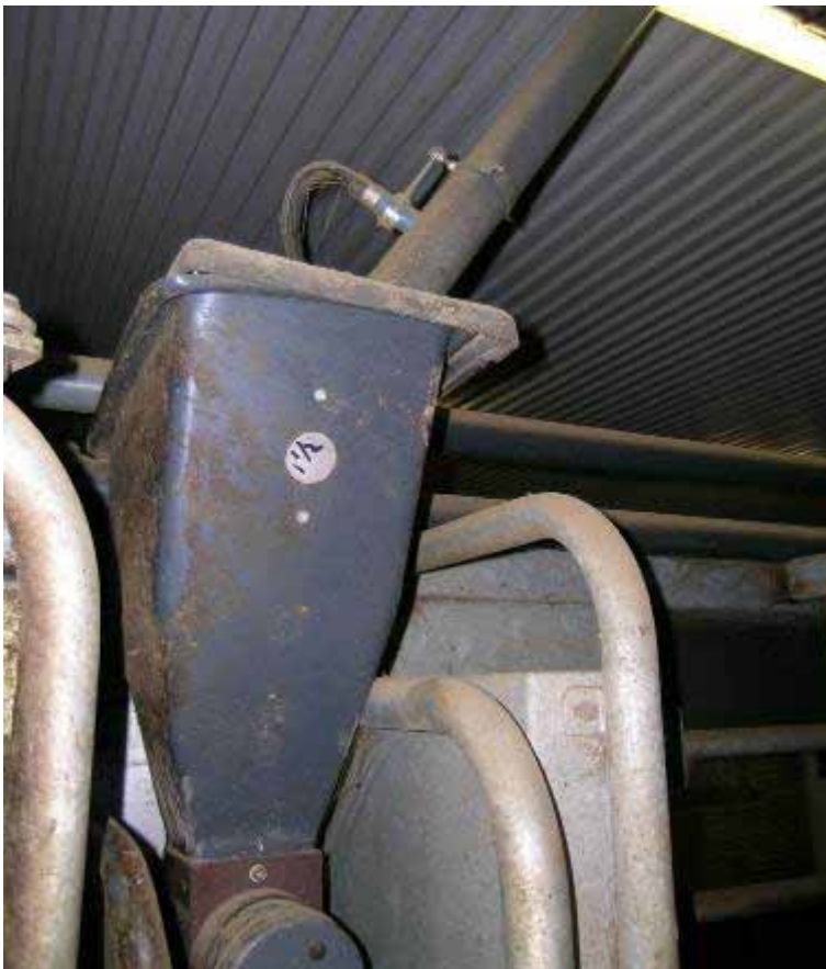
Figur 6.3. Fødesystemet er godt dimensioneret og afskærmet. Materialerne er velvalgte, så de ikke ruster. Der er ikke tendens til, at foderet sætter sig fast i udfodringsmekanikken.
