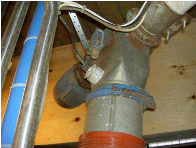
Figur 4.3. Fødesystemet er godt dimensioneret, men det er angrebet af rust efter kort tids brug. Overfladebehandlingen kan forbedres. Bolte, møtrikker og beslag bør udføres i rustfri materialer.
