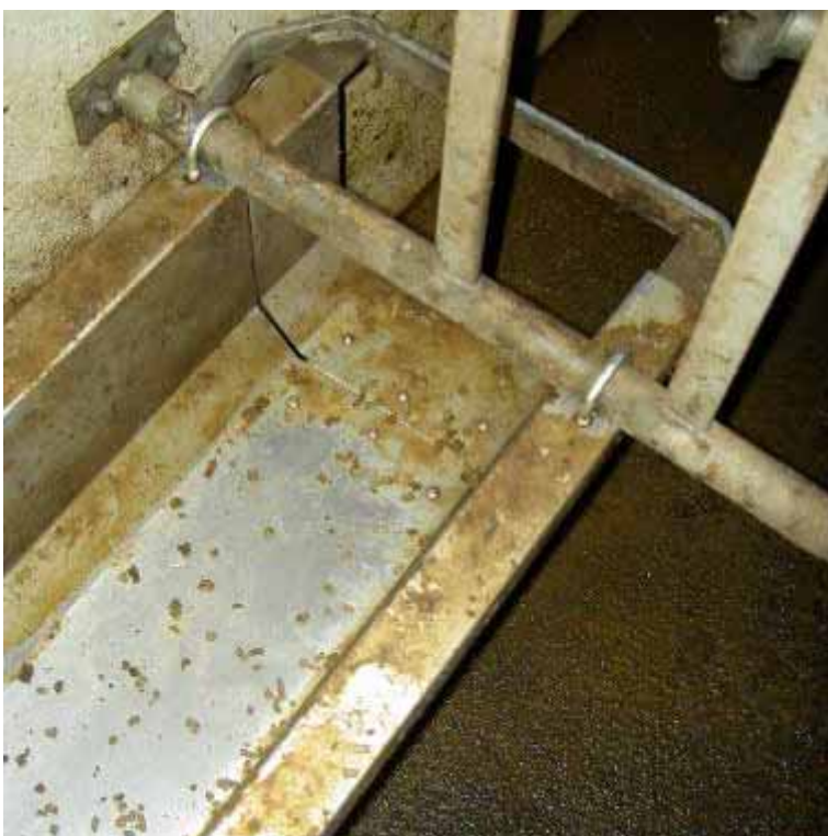
Figur 14.5. Trugets bund er let at rengøre, idet truget er åbent i enden og har et lille fald. Dermed kan det let spules rent. Den øverste kant er derimod for bred og rengøringen er vanskelig af hensyn til vand i foderrørene, som kan medføre at rørene stopper.
