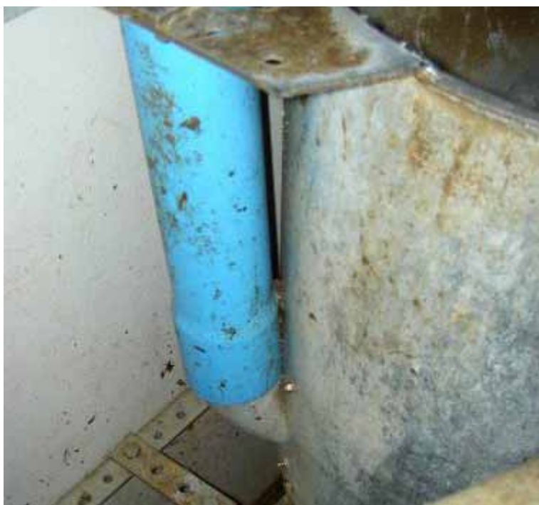
Figur 8.3. Foderrøret er godt beskyttet bag truget, og løsningen er meget solid. Røret er svært at rengøre, hvis det stopper til indvendigt.
