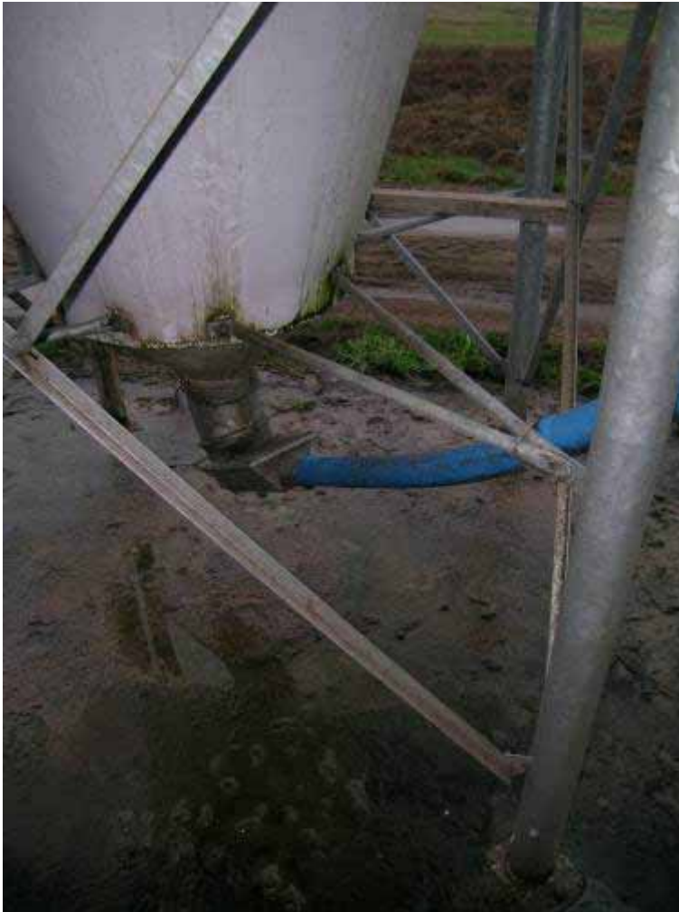
Figur 11.5. Siloanlægget var velkonstrueret og i velvalgte materialer. Her var ingen tegn på rust efter halvdanet års brug. Foderet transporteres til automaterne vha. en flexsnekl.
