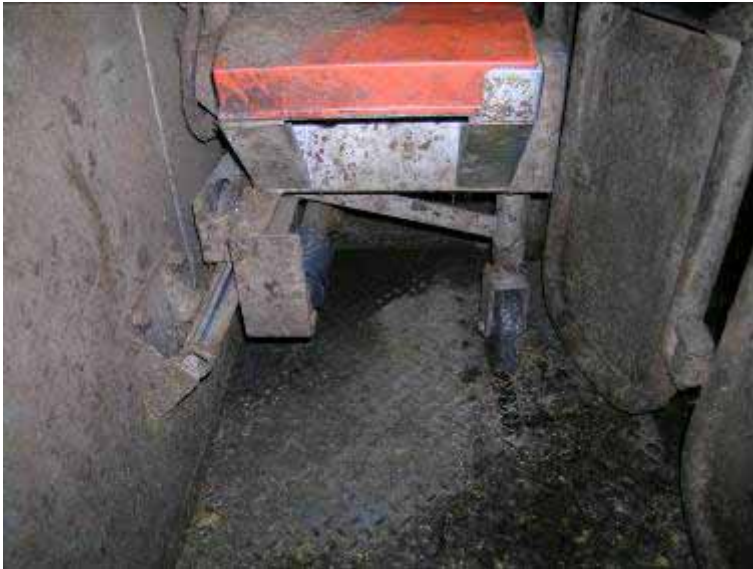
Figur 6.4. Rengøringsvenligheden er tilfredsstillende under truget. Men der er mange steder, skidtet kan sætte sig. En bedre afskærmning kunne nedsætte rengøringsbehovet.
