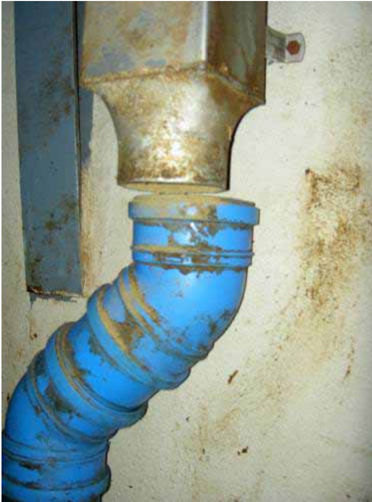
Figur 14.6. Tilstoppede rør kan være besværlige at rengøre. Her medfører bøjningen af rørføringen, at man skal skille røret ad for at rengøre den øverste del. En lige rørføring gør rengøringen lettere, og foderrester har svære ved at sætte sig.
