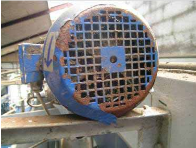
Figur 15.5. Staldmiljøet er hårdt ved motoren, som var meget angrebet af rust. En afskærmning eller bedre overfladebehandling kunne afhjælpe problemet.
