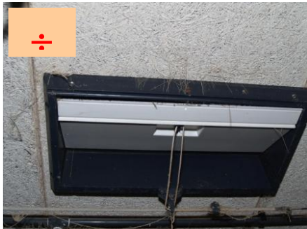
Pkt. 3 Loftventilen lukker ikke tæt
