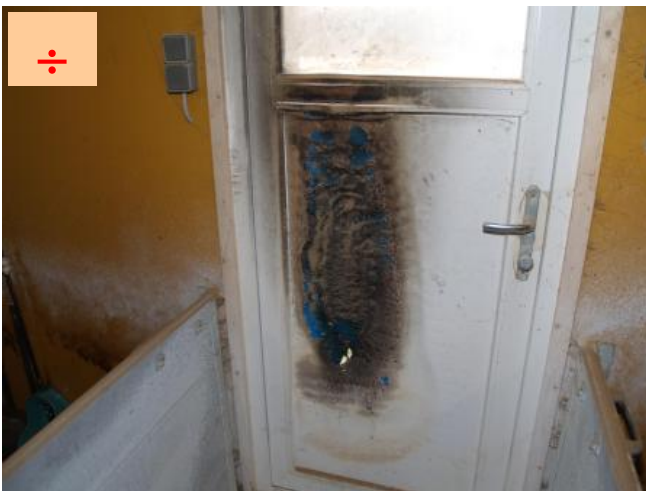
Varmekanon for tæt på dør
