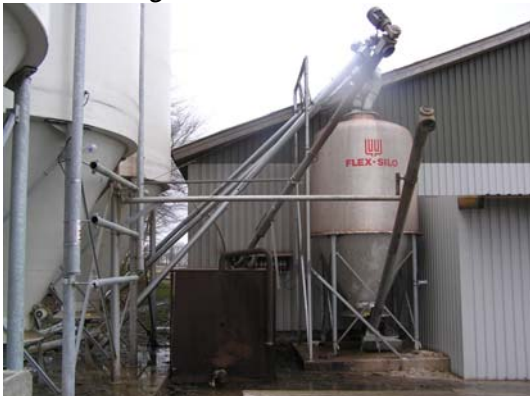
Figur 4.17. Johannes vil anbefale andre, at udtagningsiloen og mineralsiloen står indendørs for at undgå fugtproblemer.
