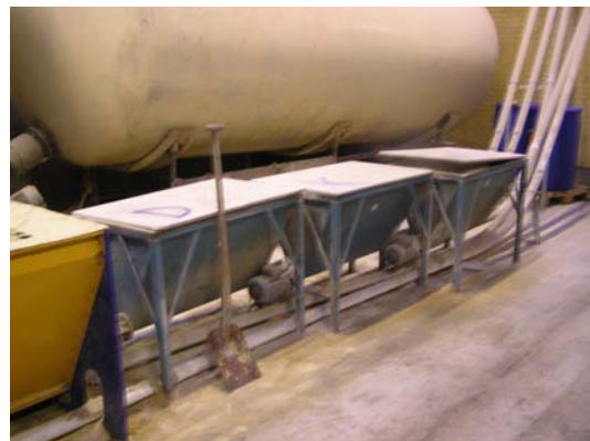
Figur 4.8. Fire mineralpåslag med flex-snegle som udtag, storsække kan ikke stå ovenpå mens de tømmes.
