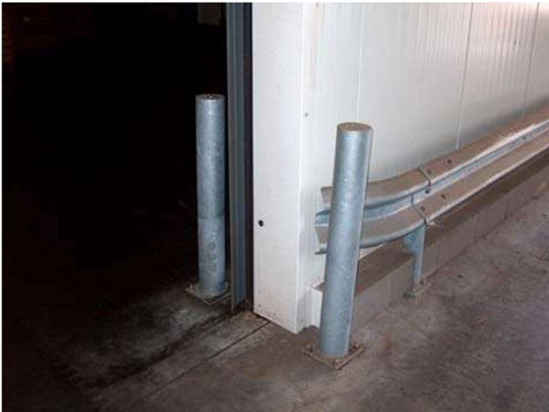
Sandwichelementerne og portåbninger bør beskyttes med kraftigt truckvæn
