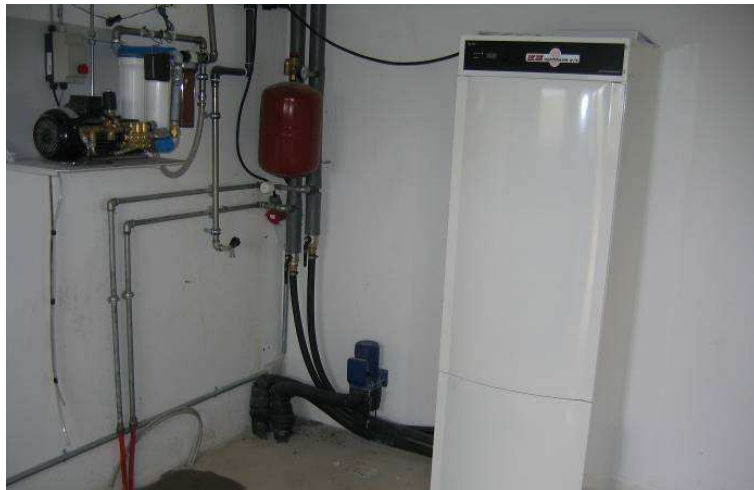
Varmepumpen med de synlige slangetilslutninger.
