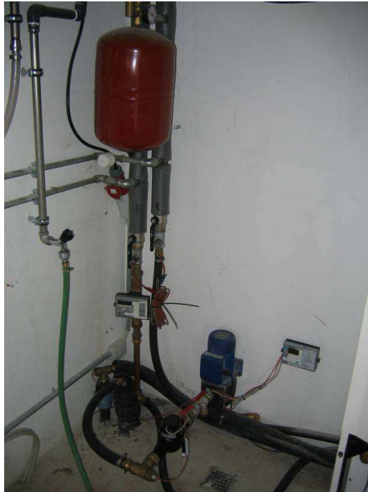
Begge varmemålere monteret.
