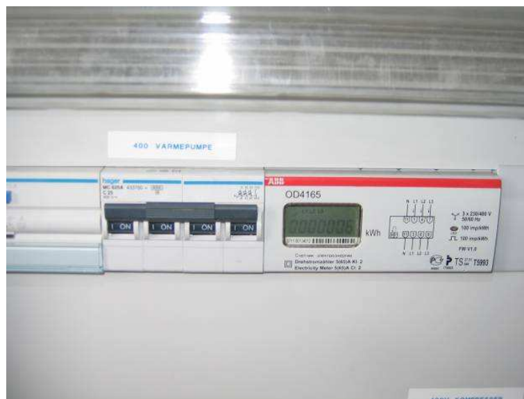
Separat elmåler til varmepumpen.
