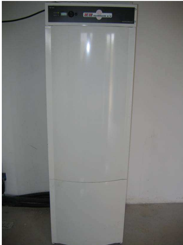
18 kW KH Nordtherm varmepumpe.
