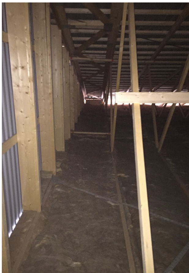
Billede 5. En trægitterspærkonstruktion, hvor der ikke ses sammenhæng mellem den udførte gavtrekant og den indlagte stabilitet i loftet.
