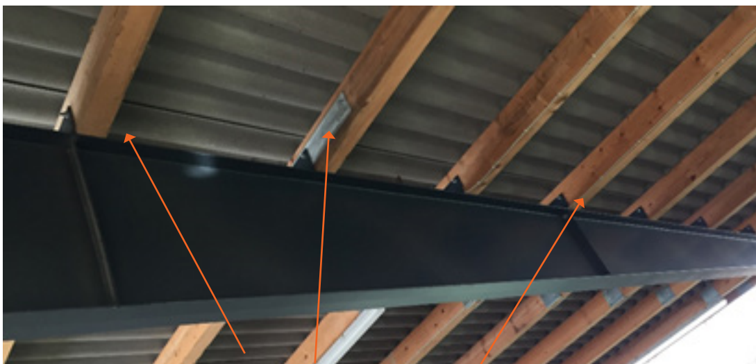
Billede 11. Kipningsbeslag monteret på forkert ås og kipningsbeslag mangler, således de rigtige steder ligesom åse ikke er forstærket.
