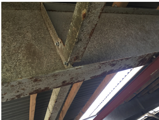
Billede 22. Konstruktion med problemer med malingstype og/eller den grundlæggende afrensning før malerbehandling.
