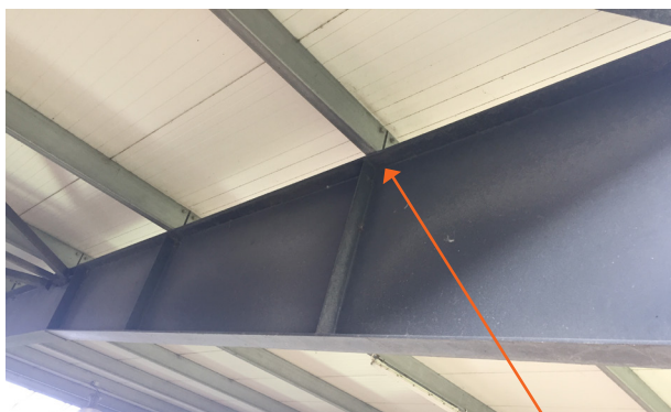
Billede 8. Intet kipningsbeslag monteret over kropsafstivning
