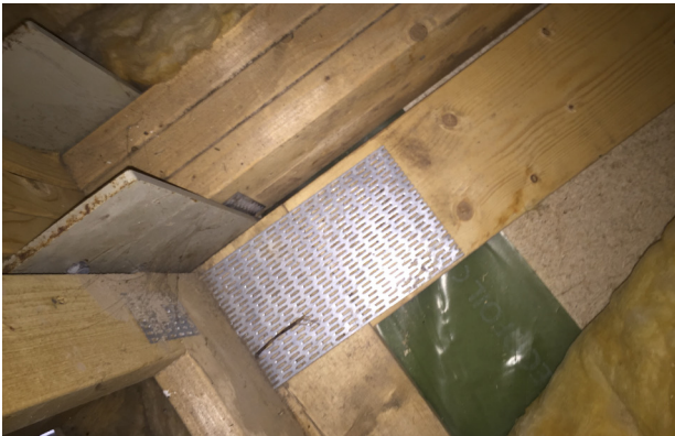
Billede 26. Ingen forankring af det tværgående gitter i loft til langsgående mellemunderstøtning, hvor det er delt.
