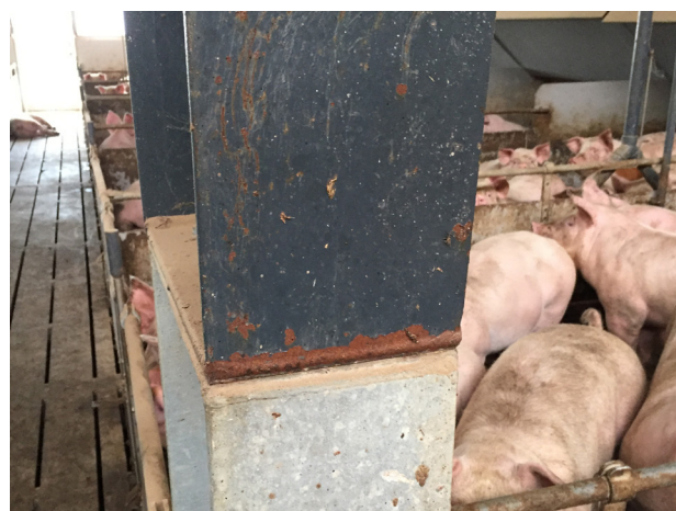
Billede 23. Rustskader, formodentligt på baggrund af manglende afrensning af svejseslagge før maling.
