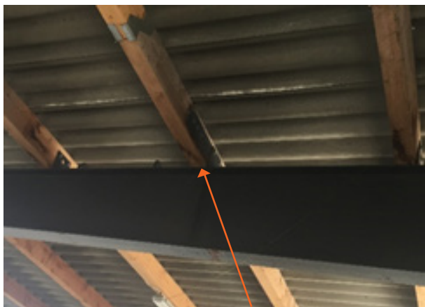
Billede 9. Kipningsbeslag monteret, men ås er ikke forstærket.
