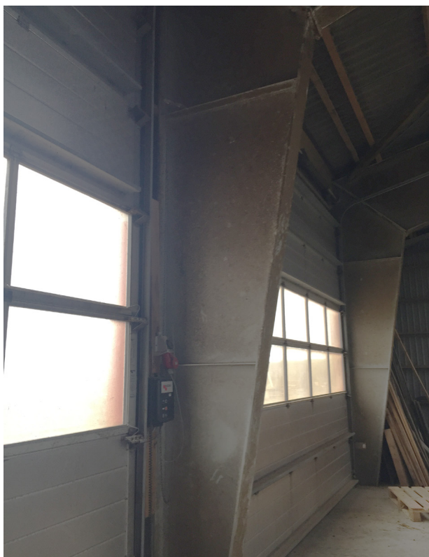
Billede 6. Rammeben med to indsvøjede kropsafstivninger, der fortæller, at spær leverandøren har forudsat to kipningsfastholdelser, hvilket ikke kan lade sig gøre på rammeben placeret mellem to porte.
