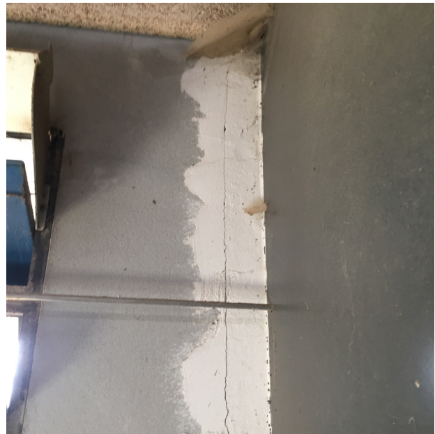
Billede 27. Uden fastgørelsesbeslag Revnedannelse mellem beton, udstøbning og stål.
