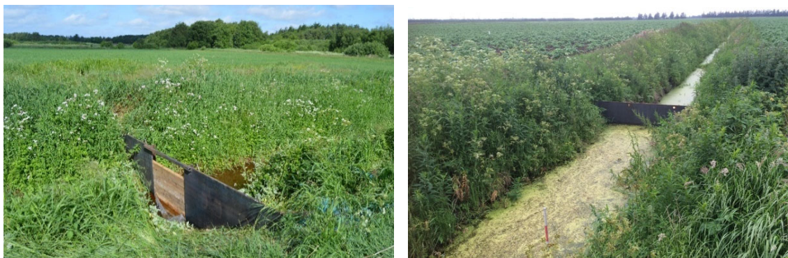
Simple spunsvægge som er sat ned i lavbundslande, men ikke i paludikultur sammenhænge.
