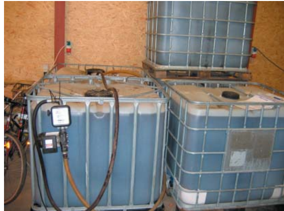
Figur 7.20. Palletanke til lagring af rapsolie.
