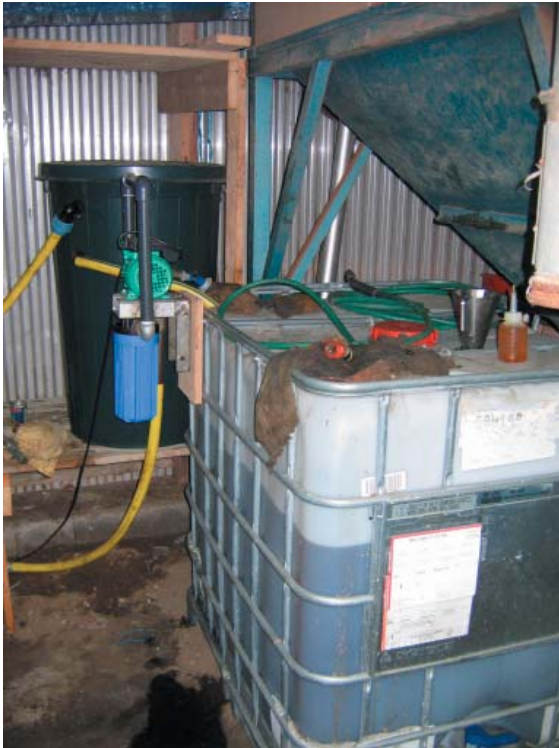
Figur 7.19. Palletank som bundfældningstank. Bemærk filteret er monteret til venstre på tanken.
