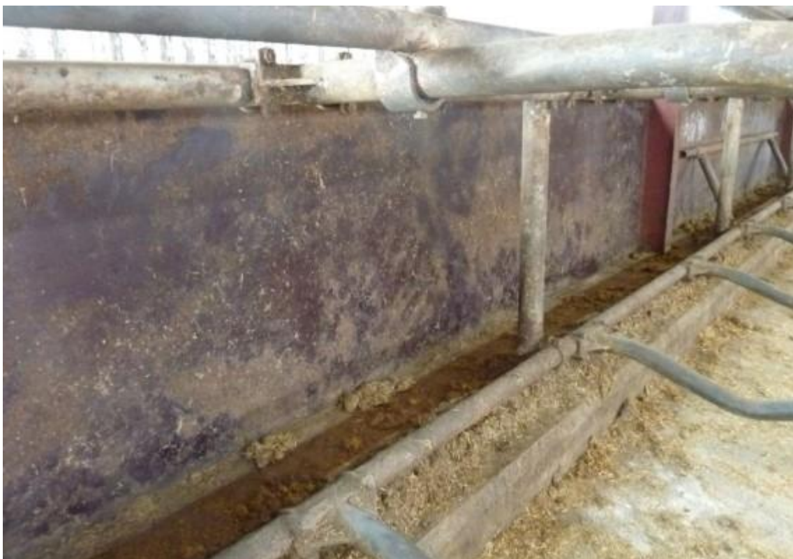
Billede 1. Denne besætning havde en udfordring med at sengene var placeret helt op af staldens ydervæg, som billedet viser her. Det valgte besætningen at gøre noget ved, dog ikke helt med den ønskede effekt. Læg i den forbindelse til mærke til frontrøret og betonhovedpuden her på billedet.
