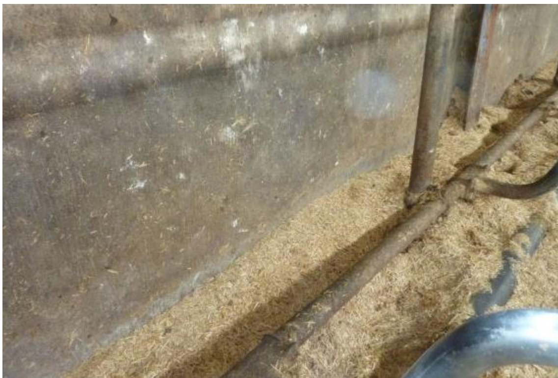
Billede 2. Billedet viser hvor lidt plads der er fra brystbommen og til frontrøret og væggen. Sengene er kun 2,45 m lange. Løsningen vil være at tage ydervæggen ned og flytte gardinet ud, så sengene bliver 3 meter lange. Desuden at skifte sengebøjlerne til en gode sengebøjler på stolper.
