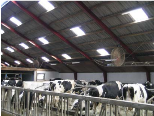
Figur 4.2. Lodret monteret ventilator placeret over malkestalden, så den blæser hen- over opsamlingsarealet.
