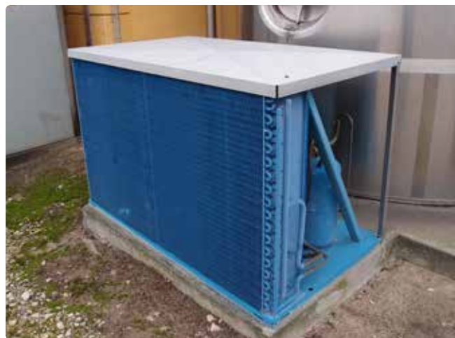
Fig. 12. Udendørs placeret kølemaskine.
