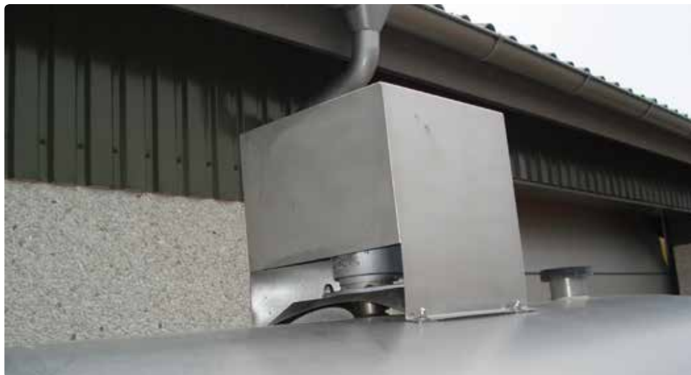
Fig. 8. Inddækning af motor til røreværk.
