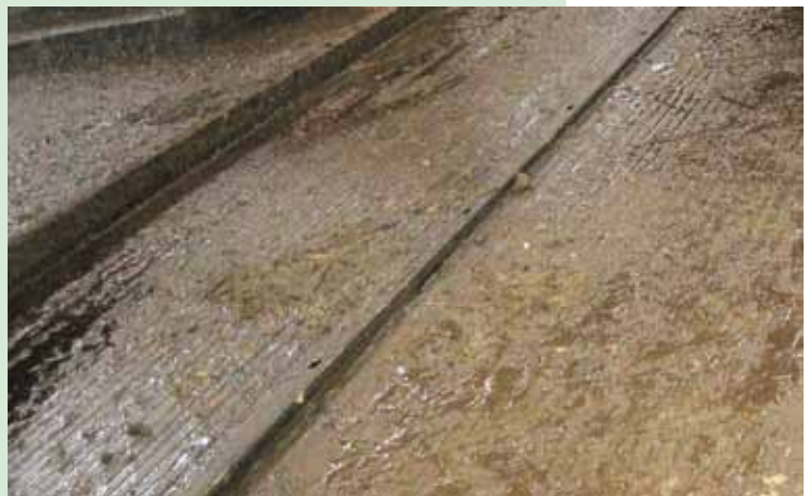
Figur 4.11: En hydrauliskskinne, som ikke er nedfaldet i gulvet, kan resultere i skader på klovene
