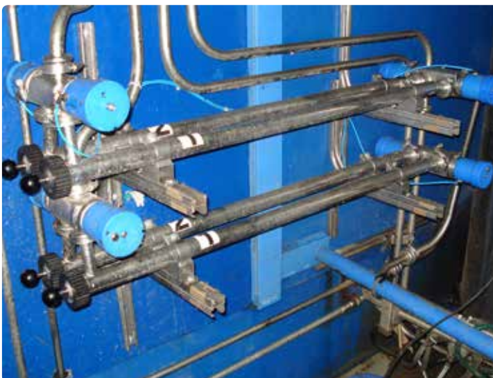
Figur 5. AMS-anlæg med automatisk filterskifte.
