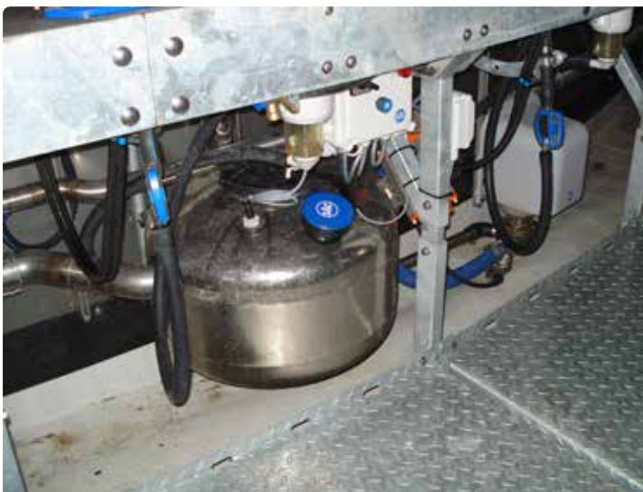
Figur 6. Mælkeudskiller på stor malkekarrusel udført i rustfrit stål.
