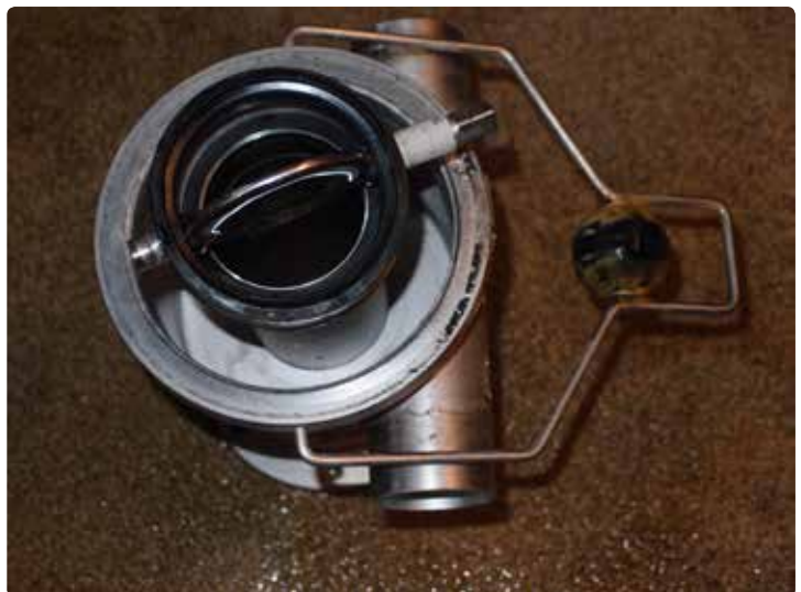
Figur 1. Udløbsventil på mælkekøletank.
