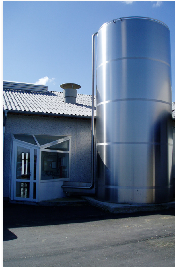
Aftræksskorsten med ventilation ført op gennem loftet.
