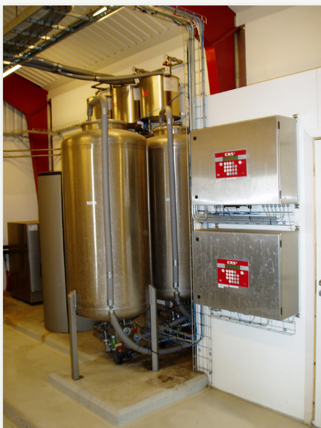
Buffertank placeret i mælkerummet. Tanken er placeret på ben for direkte tømning.
