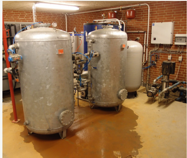
VVS installation med hovedindføring af vand, vandrensning og husvandværk
