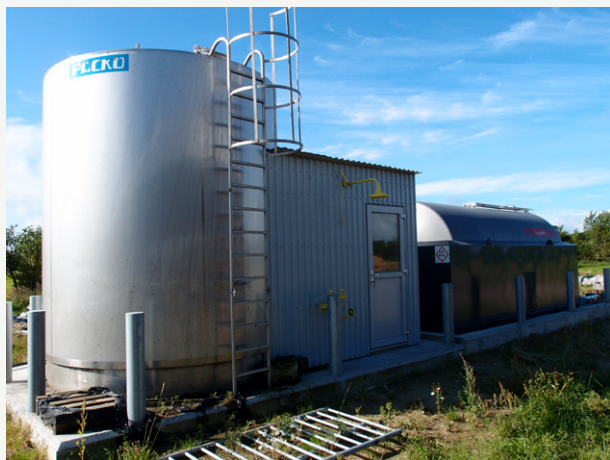
Eksempel på vandinstallation med opsamling af vand fra forkøling, vandet genbruges som drikkevand til dyrene
