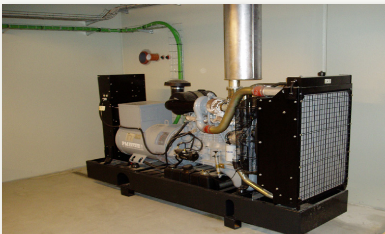
Nødstrømsgenerator med stationær dieselmotor med udstødningen ført ud i det fri
