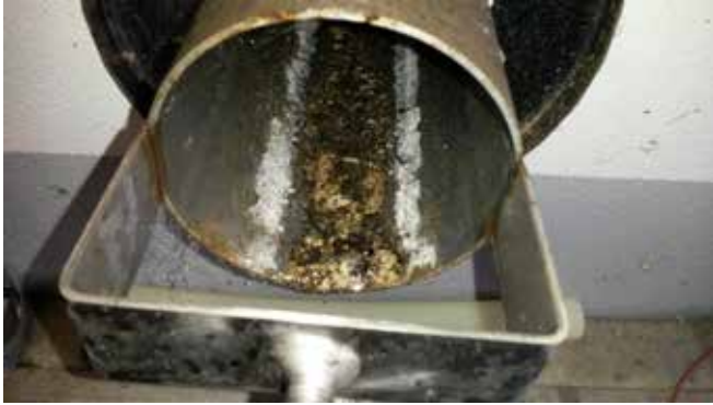
Fig 5. Husk også at tjekke tankeudluftningen.
