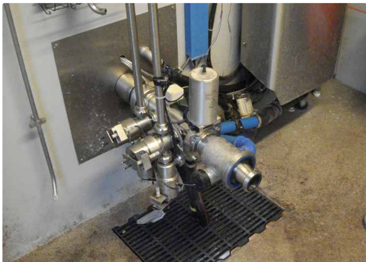
Figur 7. Ventilbatteri fra malkebotter til mælkekøletank.
