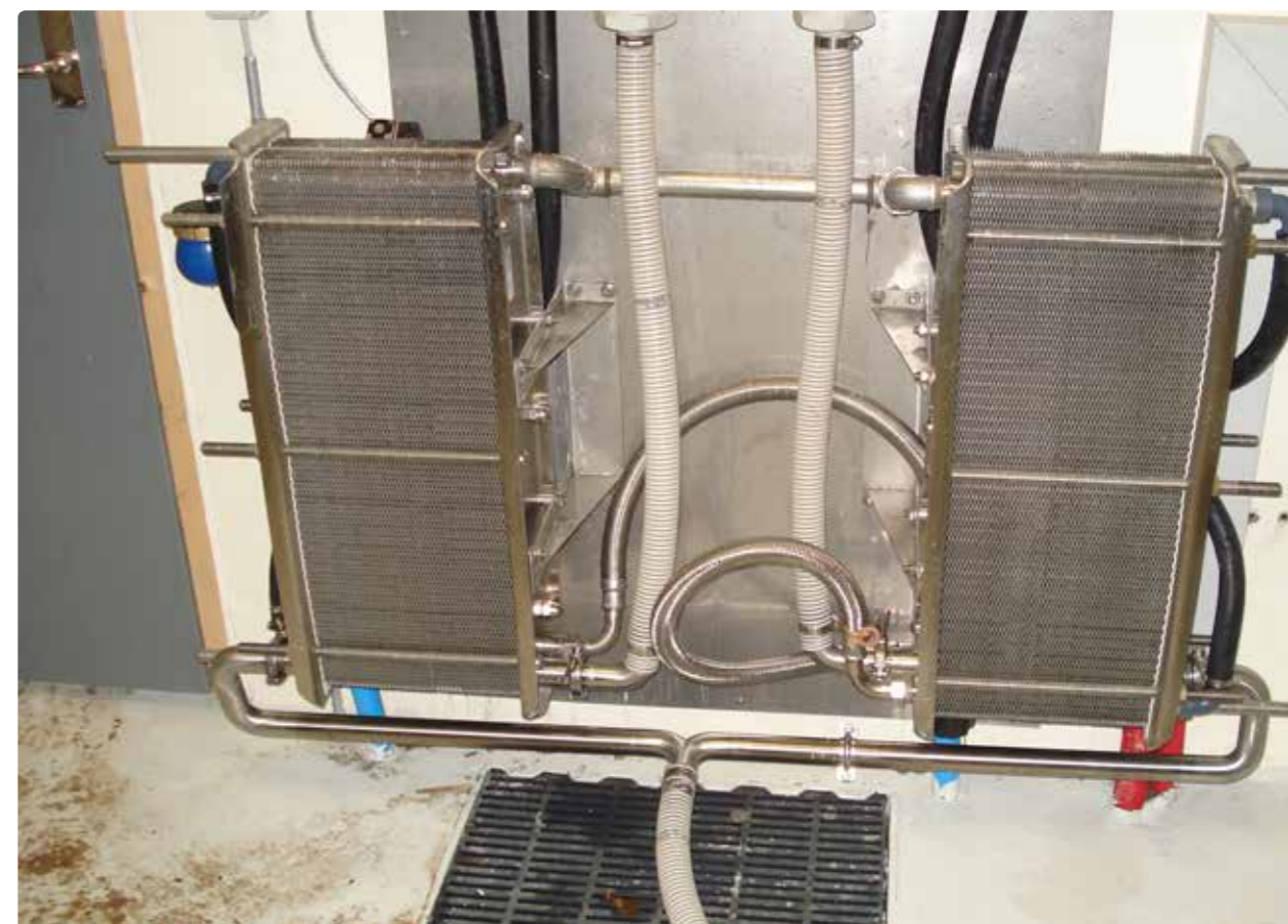
Figur 8. Dobbelt pladekøler på stor side by side malkestald.
